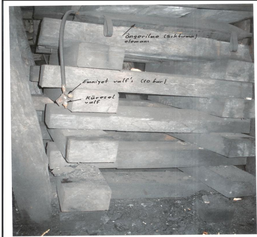
Şekil -20 Ocaklarımızda kullanılan ön gerilme elemanlı yeni domuzdamlarından bir görünüş
