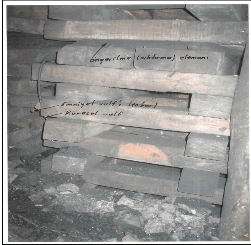
Şekil-21 Ocaklarımızda kullanılan ön gerilme elemanlı yeni domuzdamlarından bir görünüş
